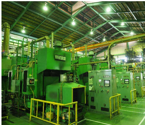
日高工業株式会社の設備
